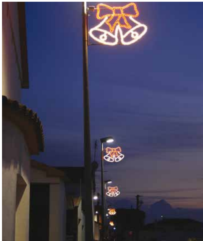
Sucesión de campanas montadas directamente en farolas de calle ancha Successió de campanes muntades directament a fanal en un carrer ample. Foto: Provincia de Girona
