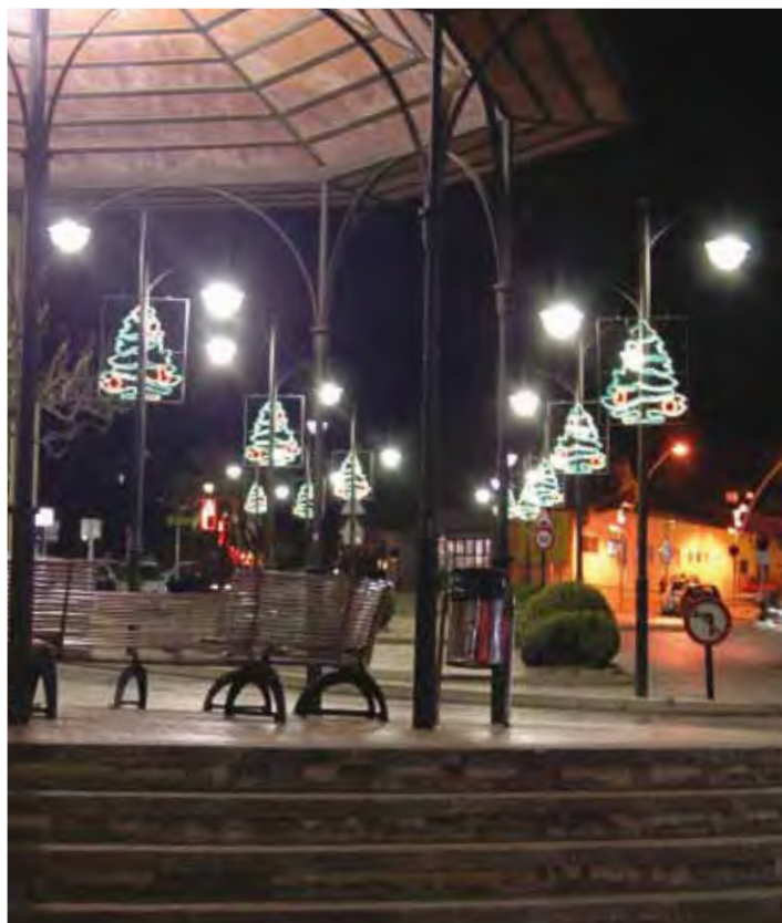
Sucesión de Montajes directos en farola alrededor de una pérgola Successió de Muntatges directes a fanal al voltant d'una pèrgola Foto: Prov de Barcelona
